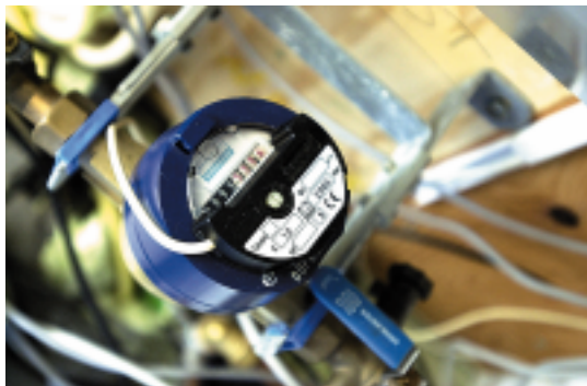
Waterpulsmeter als signaal voor alarmering.
