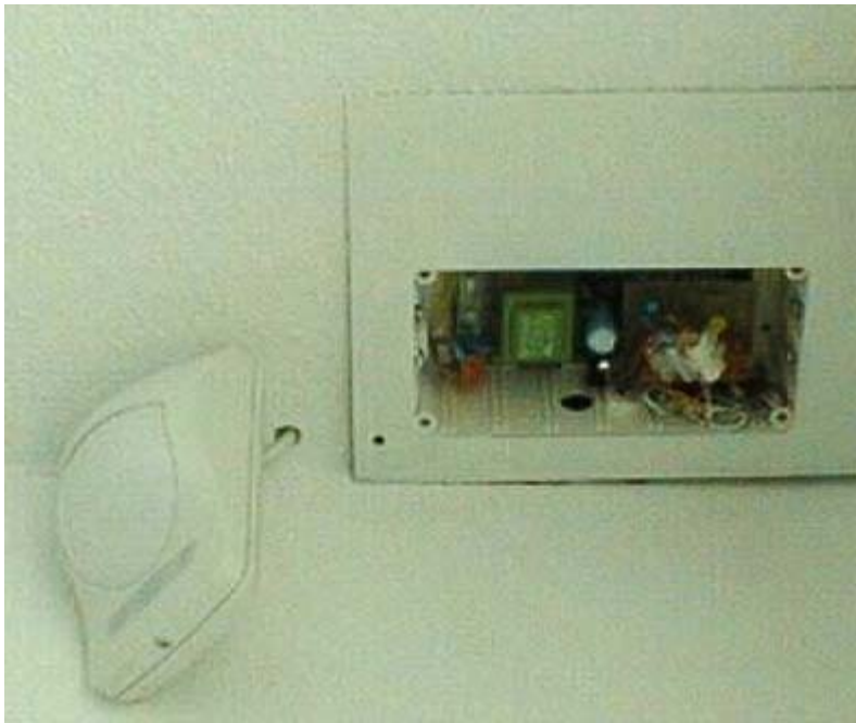
Figuur 7: Aanwezigheidsdetector en roomcontroller
