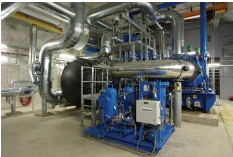
Figuur 8.1 De ondergronds geplaatste warmtepompen Bron: Helsingin Energia
