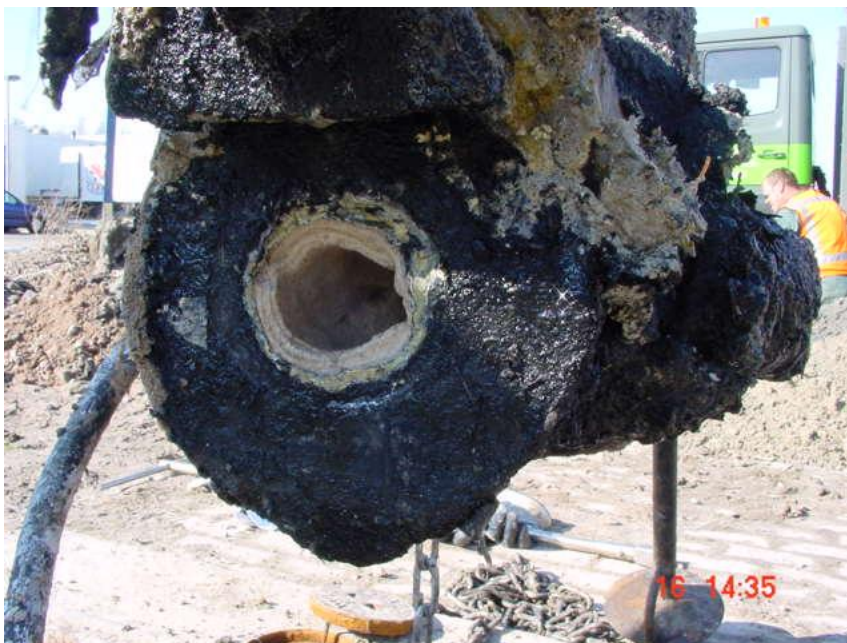
Figuur 4.2 Neerslag van calciumcarbonaat (binnenste witte rand) in beschadigde pomp
